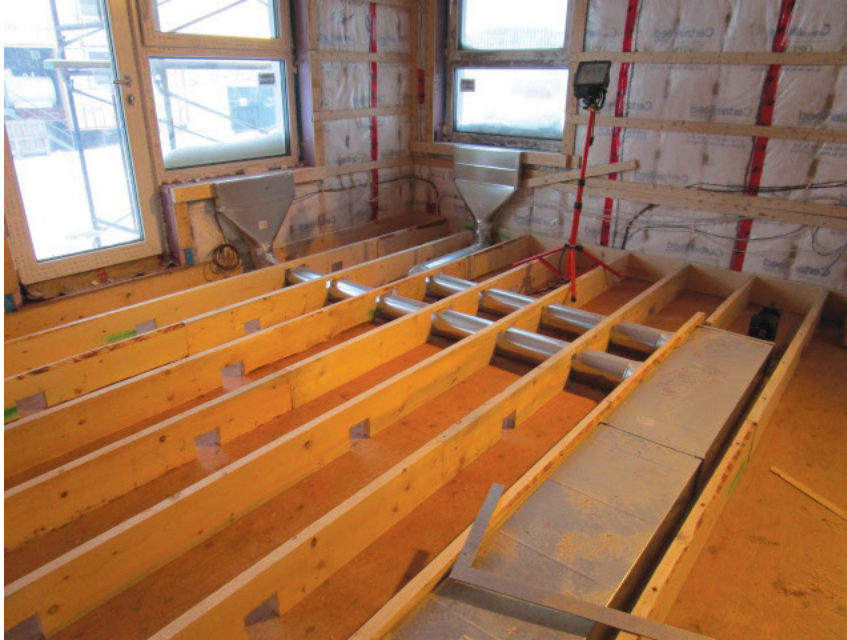
Figure 14 : Conduits de ventilation dans l'entre-plancher
