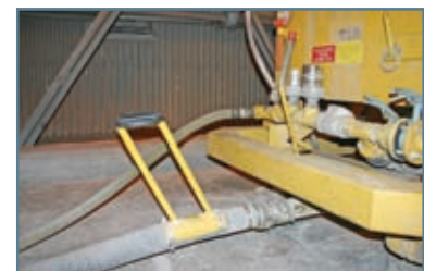
Le dispositif installé à la citerne de bain.
