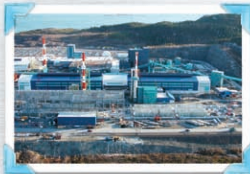
5 novembre 2003 - Le secteur des anodes n'a plus le même portait. La construction du nouveau four va bon train.
