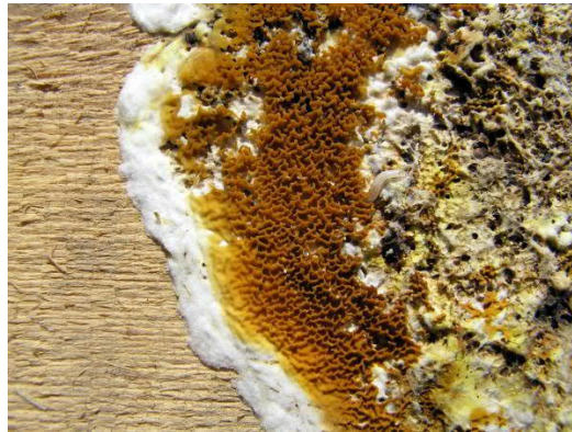
PHOTO L.1 — MÉRULE PLEUREUSE (Source : Wikipédia.)
