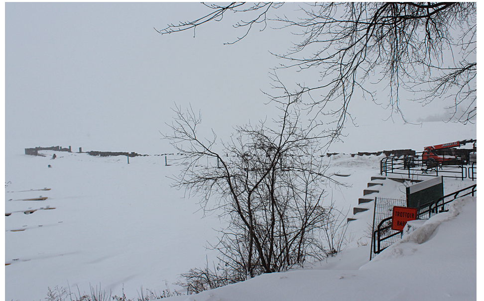
Les travaux sur la jetée de Chambly sont arrêtés prématurément à cause du niveau d'eau de la rivière Richelieu. (Photo : Frédéric Khalkhal)
