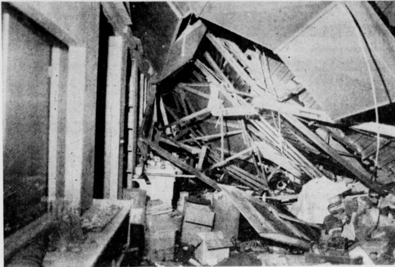
Les décors de la pièce La Cuisine ont été détruits par l'effondrement.
