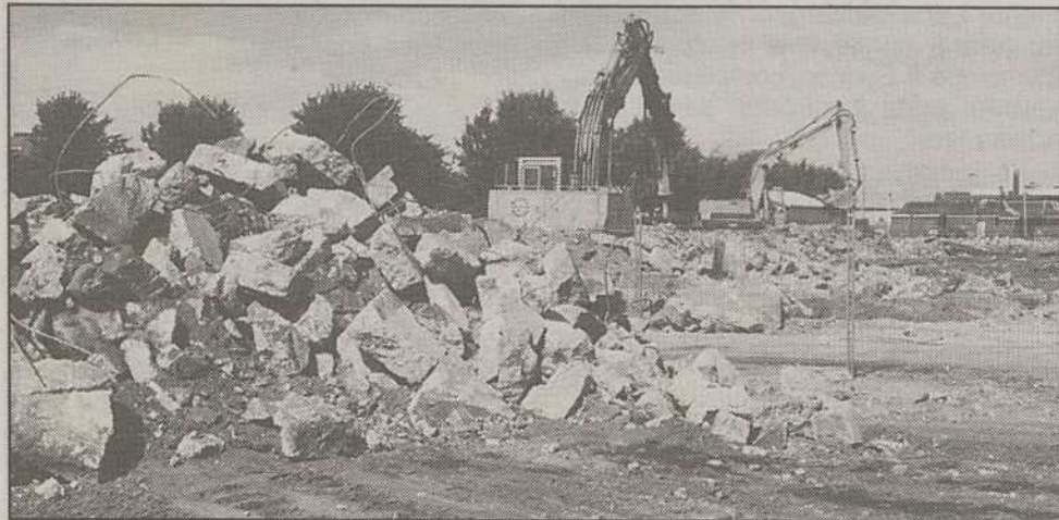
Comme on peut le constater ici, la démolition de l'ancien Yamaska Automobiles est pratiquement complétée.
