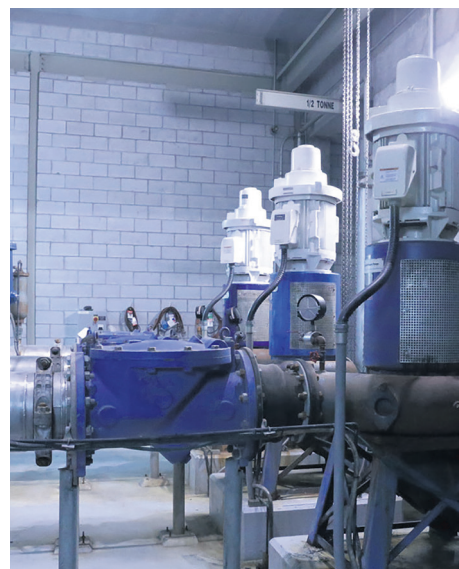
Usine de traitement des eaux usées
