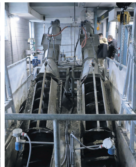
Dégrilleur de l'usine
