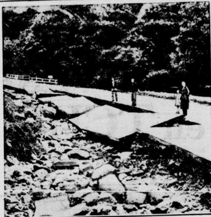
Une pluie torrentielle qui dura neuf jours a labouré la route No 9 entre Hartford et Middletown, Connecticut. Ce fut pire qu'en 1936.
