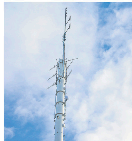
L'antenne de radiocommunications est essentielle pour les communications d'urgence. Photo: François Larivière
