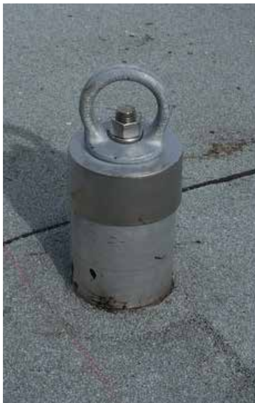
Encrage de sécurité sur un toit « non accessible », conformément au Règlement provincial sur la santé et la sécurité du travail. Les travailleurs ou personnes responsables de l'entretien doivent accrocher le cordage de leur harnais de sécurité sur de solides encrages de ce type pour se protéger contre les chutes.
