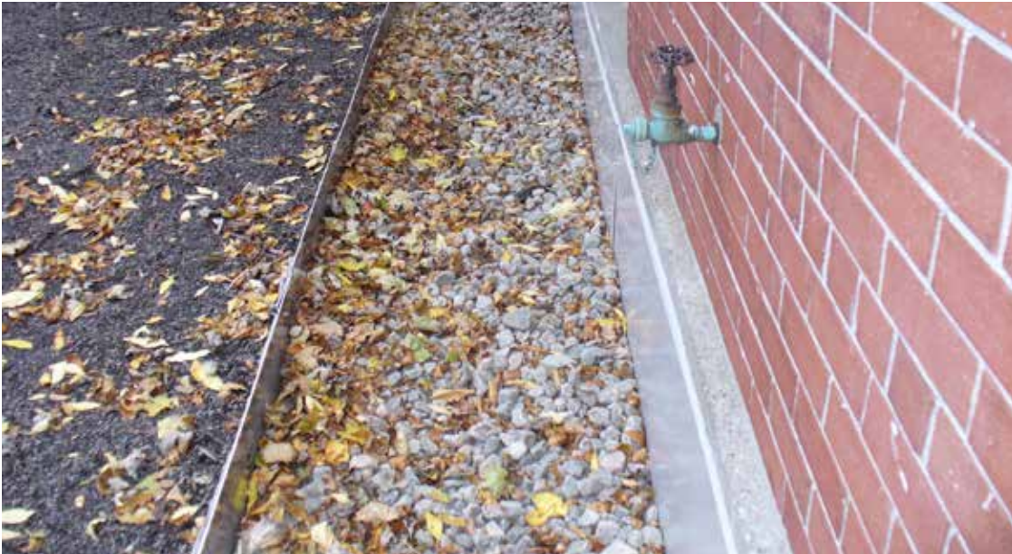
Robinet extérieur dédié à l'arrosage du toit végétalisé. Usine de filtration d'eau Atwater.
