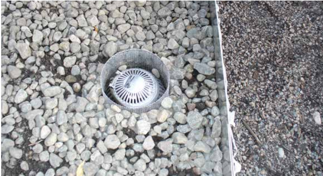
Avaloir de toit sur un des toits végétalisés de l'usine de filtration d'eau Atwater. La couche drainante se trouve sous le substrat de croissance (à droite sur la photo) et la zone libre de végétation (à gauche) constituée de gravier blanc. La bordure qui sépare les deux parties doit être installée de façon à ne pas empêcher l'écoulement des eaux sur la couche drainante. PHOTO : VILLE DE MONTRÉAL (H. CUONG NGUYEN)
