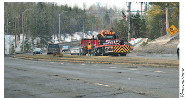
Les opérations de colmatage ont débuté dès le 3 avril sur la route 117, à Prévost
