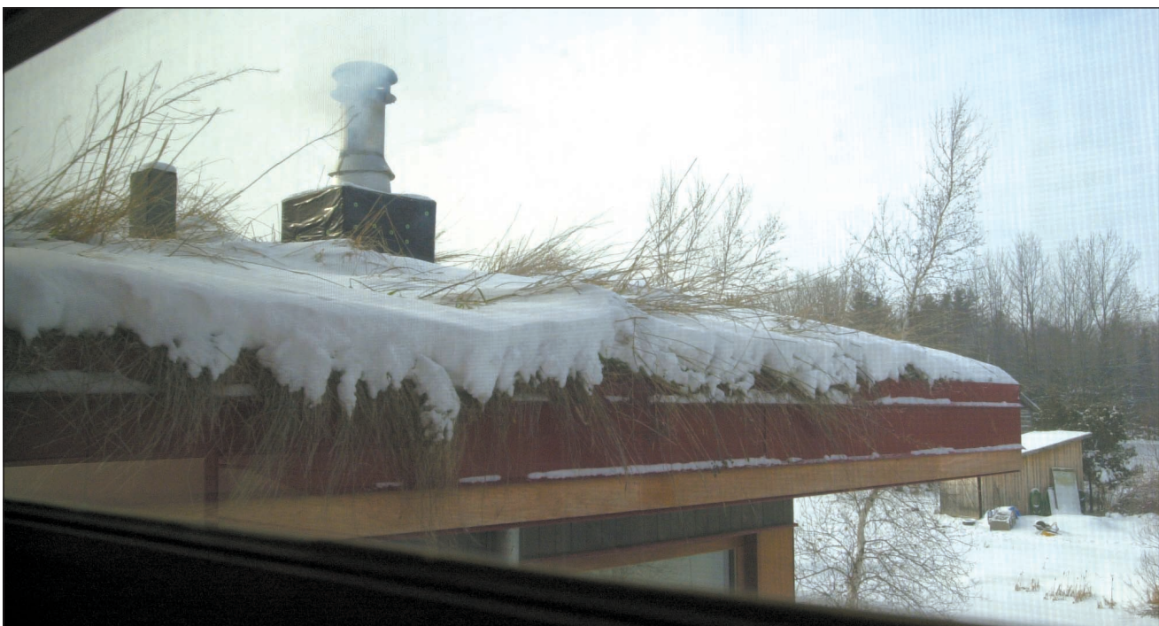
Les toits en pente surmontés de corniches jouent le rôle d'auvents en période estivale.
