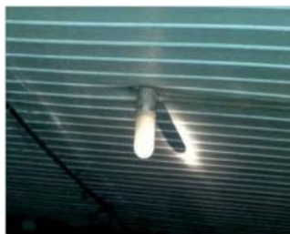
Luminaire de type marin avec ampoule au DEL et le protecteur en verre
