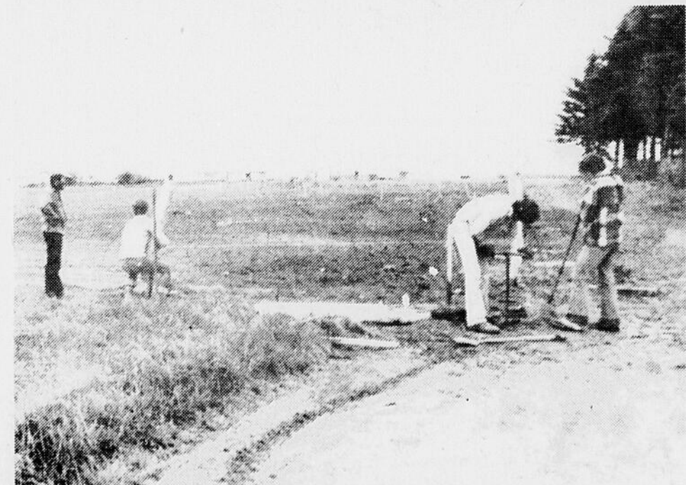
LA CLOTURE — Une partie du groupe de Jeunesse-Canada au Travail s'affaire à planter les poteaux de la clôture qui protégeront les jardins contre les plus curieux tandis qu'on remarque, à l'arrière-plan, le nouveau parc des maisons mobiles situé près de la cité étudiante.
