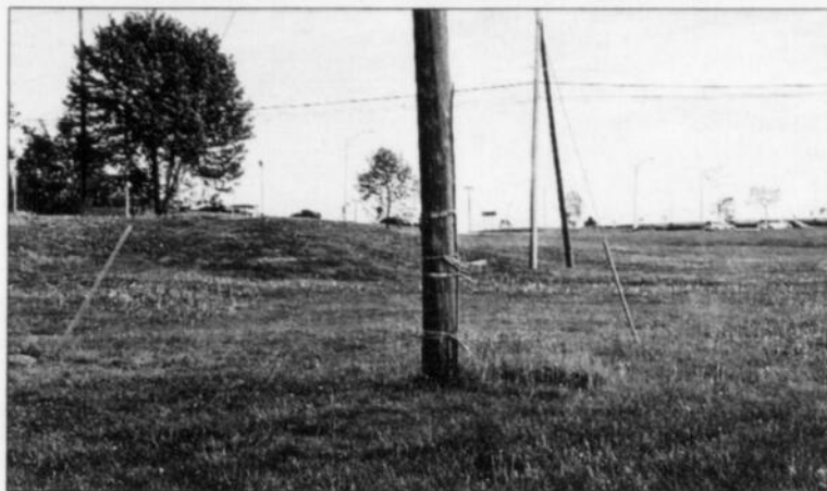
Un hauban jaune a été installé sur le câble d'acier servant à stabiliser un poteau sur un terrain situé à proximité de la polyvalente de Jonquière. L'histoire ne dit pas si c'est Hydro-Québec ou un autre organisme qui a procédé à l'installation du hauban.
