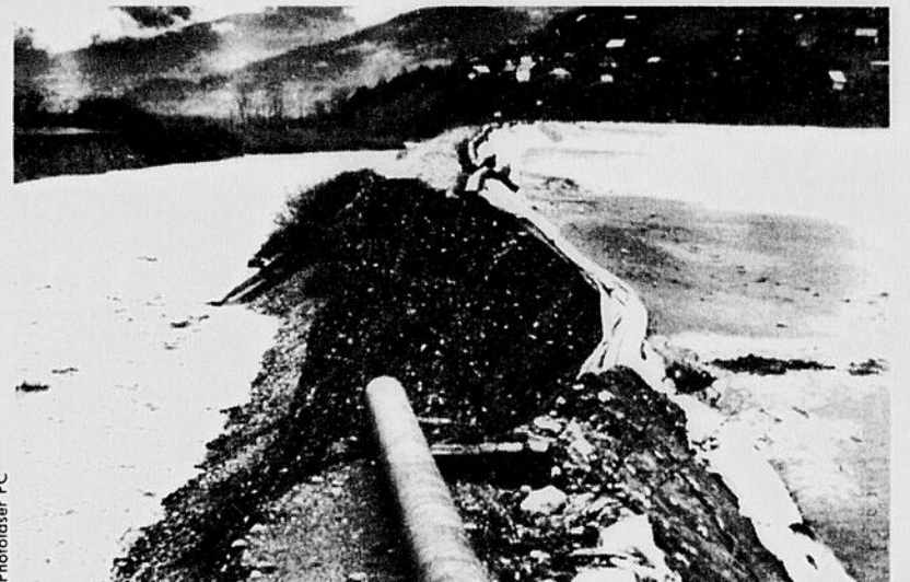
Les inondations éclair du mois d'octobre ont gravement endommagé le barrage en terre qui retient de grandes quantités de matières toxiques, en bordure de la rivière Tara, dans l'ex-Yougoslavie.
