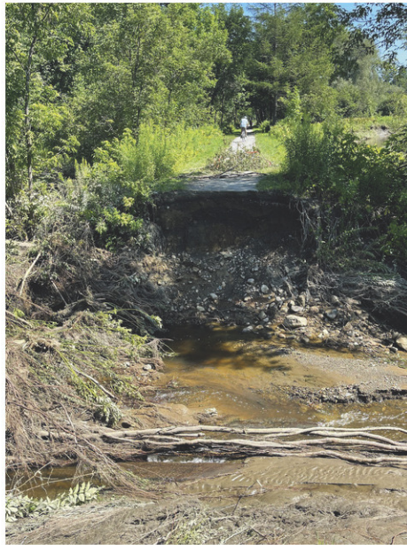
Les dommages sont concentrés au kilomètre 9, près du chemin Curtis. (Photo gracieuseté)
