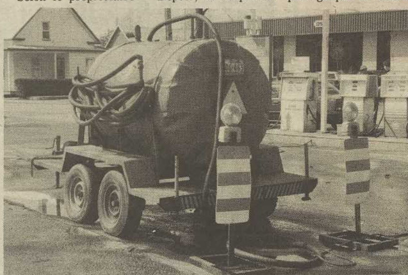
La voirie municipale d'Acton Vale continue de pomper l'essence qui se ramasse dans la tranchée de récupération.
