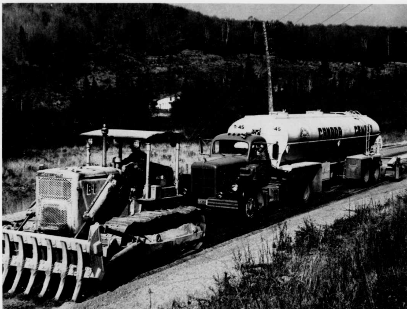
Après la scarification de la route, on procède à l'épandage du ciment, et ensuite au malaxage des matériaux.
