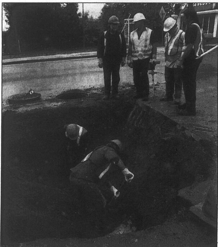
Une équipe du ministère des Transports et des travaux publics de la Ville de Lac-Mégantic travaillait à colmater la brèche, tôt vendredi matin.
