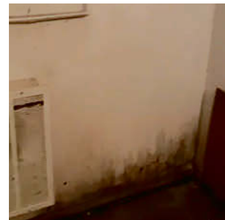
De la moisissure est visible au sous-sol du bâtiment. Photo gracieuseté
