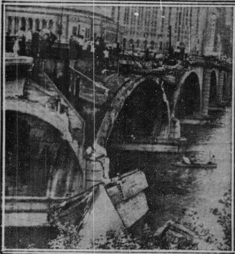
NON, ce ne sont pas les bombes, c'est tout simplement la foudre qui toucha durement ce pont, de Columbus, Ohio, jeté au-dessus de la rivière Scioto. On rapporte que plusieurs centaines de briques volèrent sous le choc.
