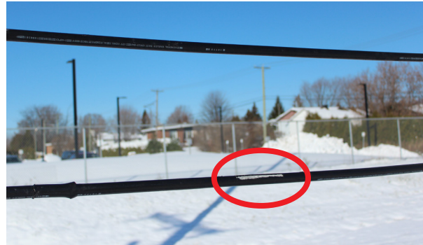
Gaine de conducteur endommagée
