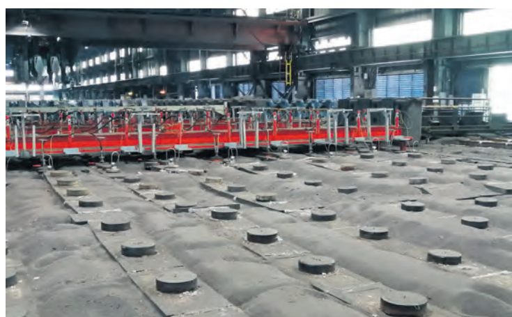
Sur la photo, on peut voir les rampes qui ont dû être remplacées. Ces appareils sont dédiés à la cuisson des anodes.
