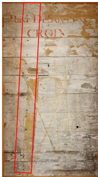
Photo 32 : rangée verticale de trous de clous au niveau de la colonne
