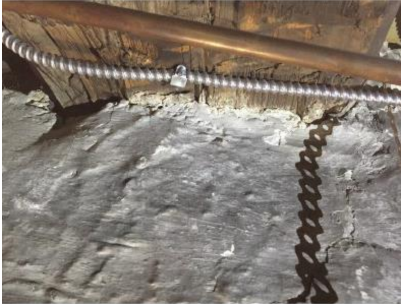
Photo 19 : enduit débordant sur la poutre du plafond, mur intérieur de l'appentis
