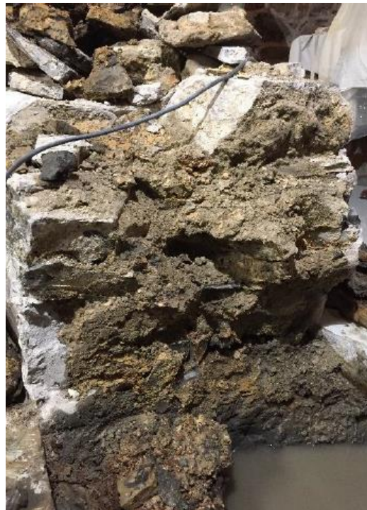
Photo 6 : remontées capillaires dans le muret
