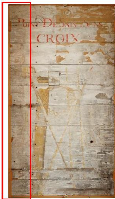
Photo 33 : zone qui semble correspondre à la marque d'une ancienne cloison ou d'une armoire
