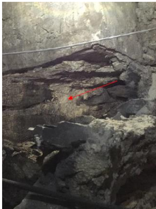
Photo 14 : mortier prélevé (n° 2.9) dans le massif de la fondation du mur du retable, côté église
