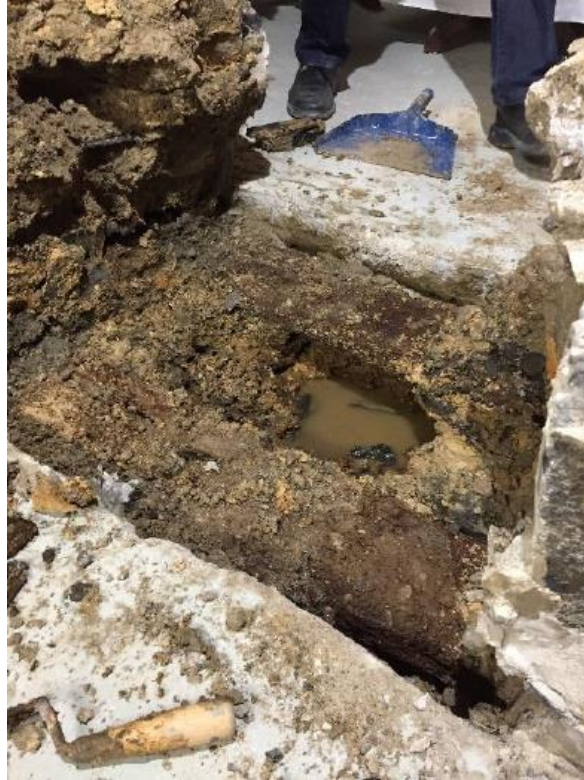
Photo 9 : deux pièces de bois sous le muret
