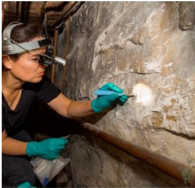
Photo 18 : échantillons prélevés de l'enduit (n° 2.2) sur le mur intérieur de l'appentis
