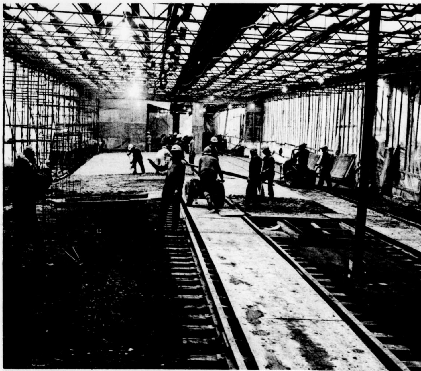
Sous cette structure temporaire recouverte de polyéthylène, on voit l'ampleur des travaux effectués à l'aire centrale. En tout, il a fallu couler du béton sur un espace de 60,000 pieds carrés pour améliorer la circulation.
