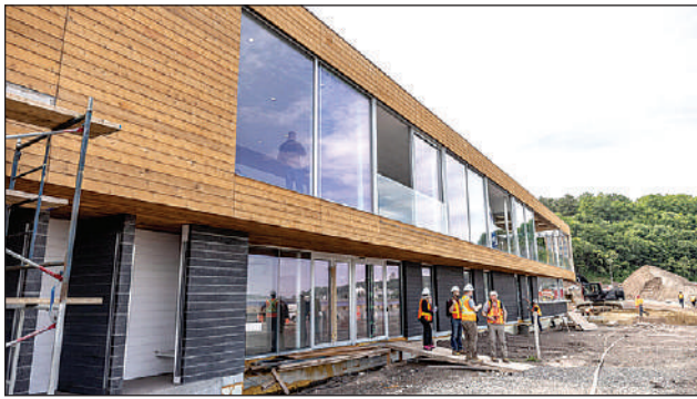
L'apparition du pavillon des Baigneurs a caractérisé la dernière année alors que ce bâtiment de services desservira notamment la plage urbaine prévue à cet endroit.
