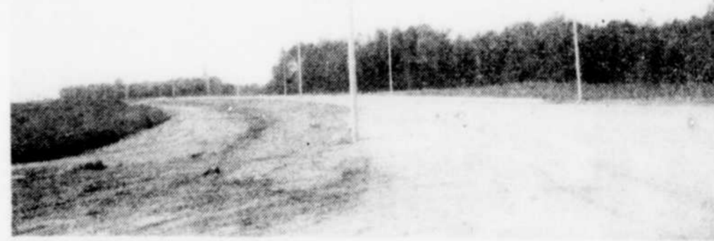
Il ne semble plus que manquer la couche d'asphalte pour l'ouverture du nouveau tronçon du boulevard Juras est, à Victoriaville. On sait qu'il s'agit là d'un projet
