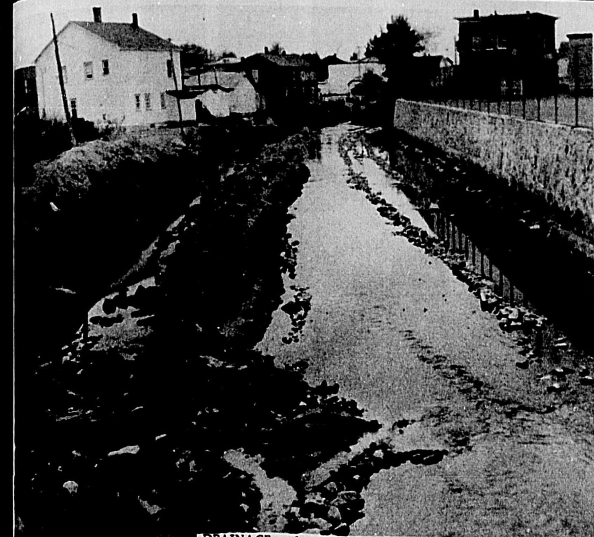
DRAINAGE -- Le gouvernement subventionne des travaux de drainage sur le parcours de la rivière Bécancour qui sillonne la ville de Thetford Mines. On peut voir sur cette photo les travaux qu'occasionnent ce projet que le gouvernement provincial a mis d'avant il y a quelques semaines.
