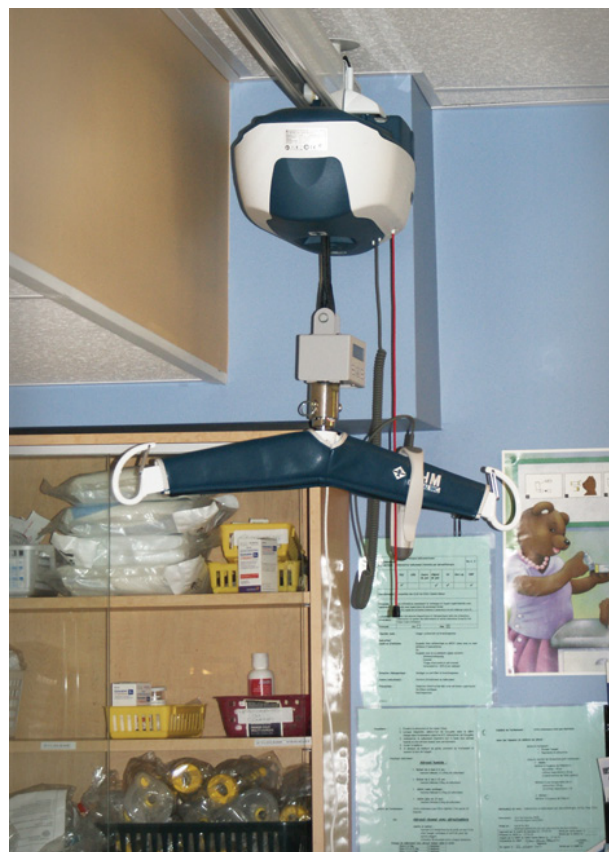
Salle de traitement-examen adaptée avec lève-personne de grande capacité au plafond.
