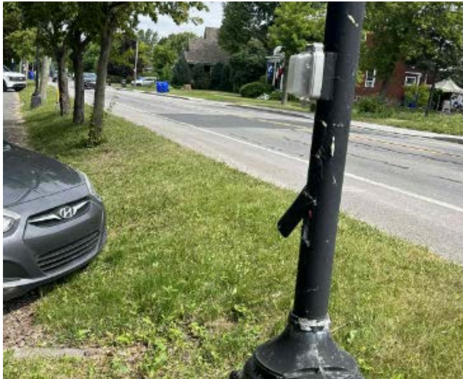
La Ville affirme que les réparations nécessitant un électricien ont été coûteuses. (Photo : Ville de Saint-Mathias-sur-Richelieu)
