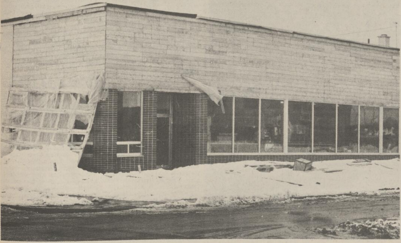
USINE - Les travaux de construction de la nouvelle usine d'emballage de la compagnie Lafrance à Saint-Hyacinthe sont presque complétés. L'édifice est situé à l'angle du boulevard Vanier et la rue Cartier. Les travaux qui ont été confiés à de multiples entrepreneurs sont de l'ordre de $120,000 (Photo Toutan)
