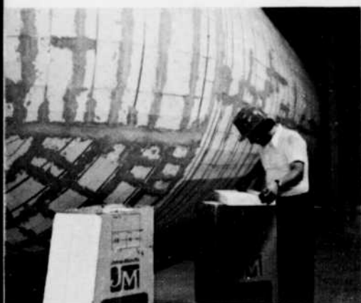
Isolant Thermo-12 de 2 1/2" de silicate de calcium revêtant un réservoir de condensation long de 122'.
