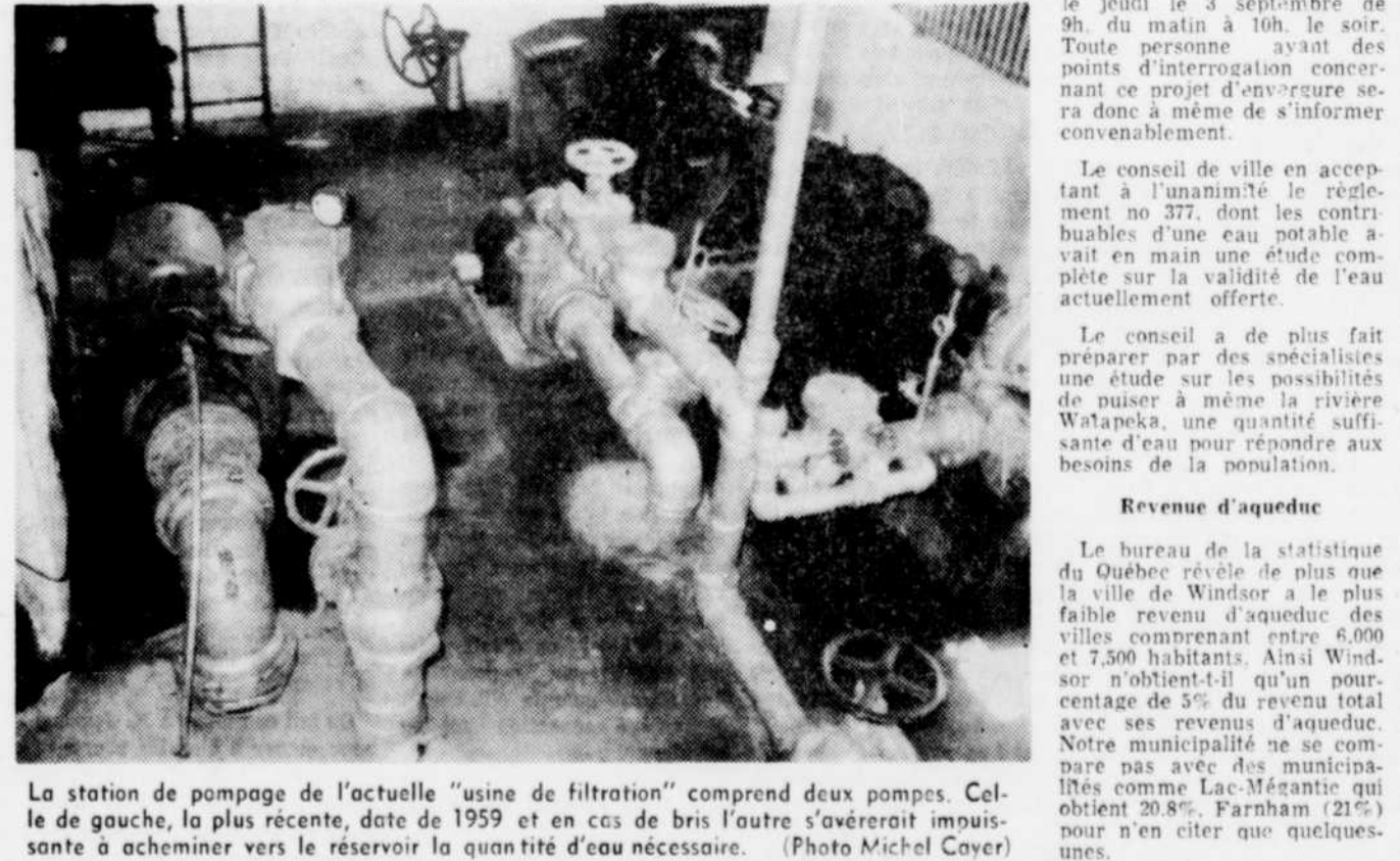
La station de pompage de l'actuelle "usine de filtration" comprend deux pompes. Celle de gauche, la plus récente, date de 1959 et en cas de bris l'autre s'avérerait impuissante à acheminer vers le réservoir la quantité d'eau nécessaire. (Photo Michel Cayer)
