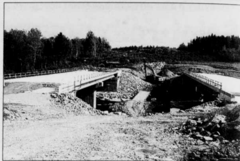
La construction des deux ponts qui enjambent la rivière du Moulin sera terminée d'ici la mi-octobre. Les structures réalisées par l'entreprise JR Savard auront coûté 4,8 millions au MTQ.
