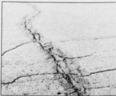
La piste de Saint-Méthode présente d'importantes fissures qui nuisent à l'atterrissage des avions de haute performance.
