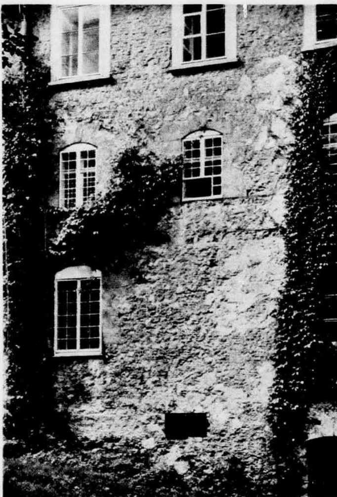
Malgré l'incendie de 1686, les vieux murs de l'aile St-Augustin, érigés en 1650, sont toujours solidement assis sur leur base.
