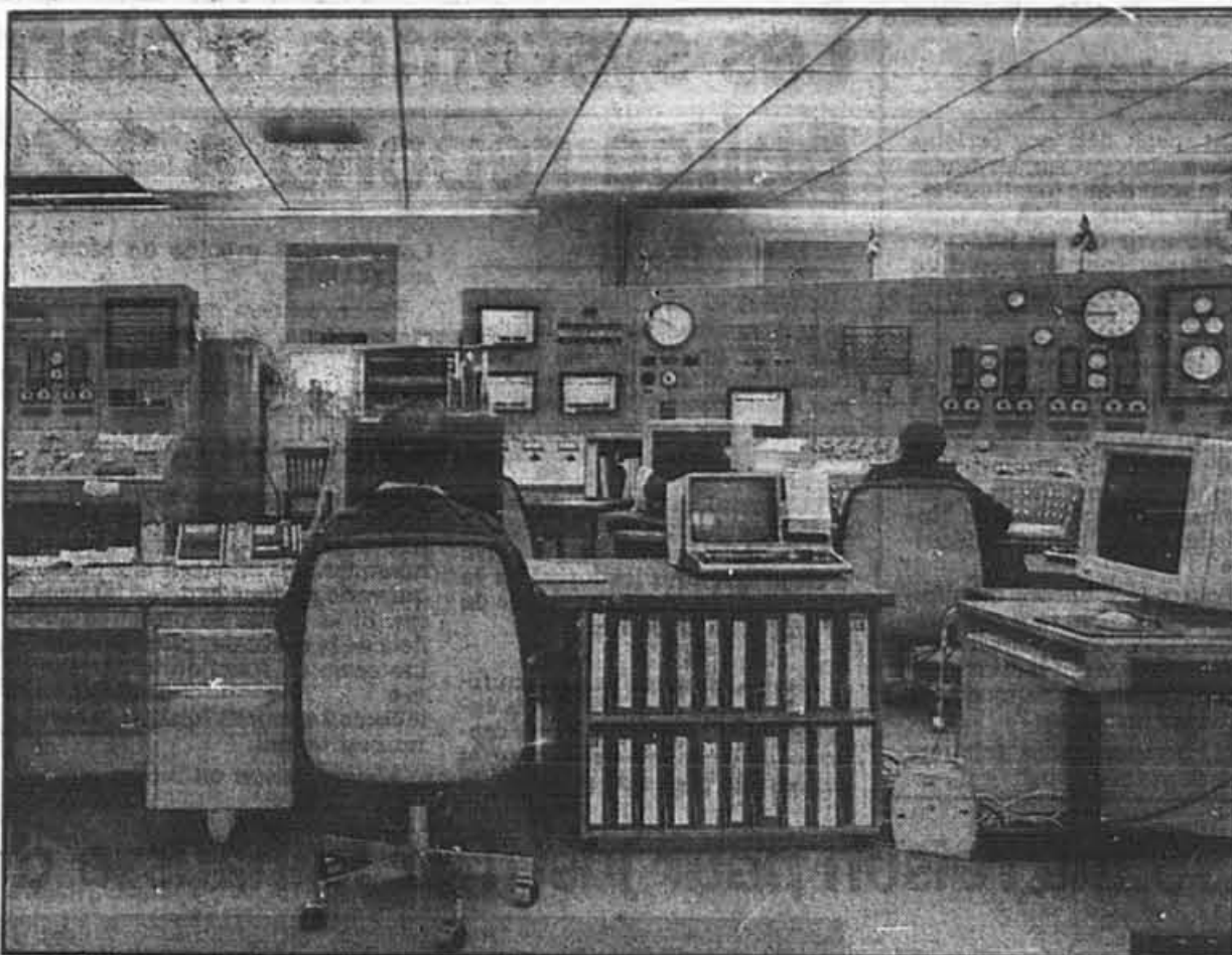
La salle de contrôle de la centrale hydro-électrique de Beauharnois. On a coupé hier matin l'électricité habituellement envoyée aux États-Unis pour accélérer la reprise du courant au Québec.
