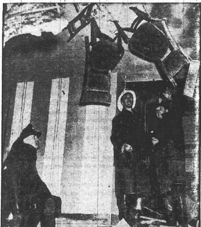
Des pompiers examinent les dommages, comprenant ces chaises fixées au plafond, à la suite d'une explosion terrible, survenue dans l'édifice de quatre étages d'une confiserie, à Buffalo, N.-Y. Trois étages se sont effondrés. Deux piétons ont été blessés grièvement dans l'explosion.
