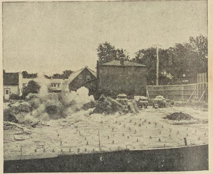
Le dynamitage fractionné, rendu possible par un nouveau type de détonateur, cause moins de bruit, de déplacement d'air et d'éclats de roc.
