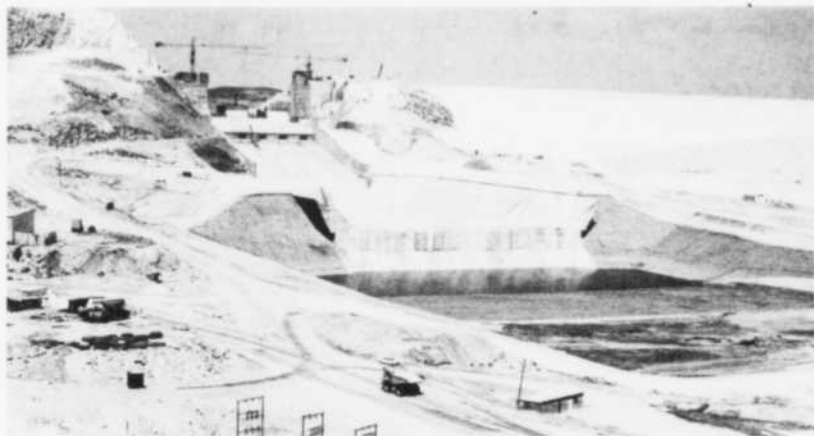
Vue partielle du barrage Bourguiba, inauguré à Sidi Saad, en Tunisie. On peut apercevoir à droite le barrage principal.
