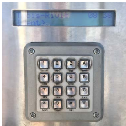
Photo 2 : Clavier numérique sur le terminal du système de contrôle d'accès
