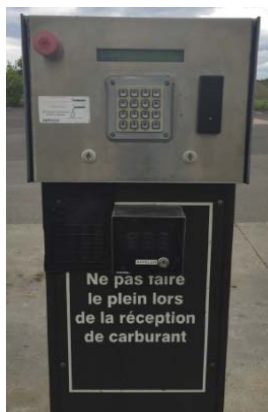
Photo 1 : Système de contrôle d'accès pour les pompes à carburant
