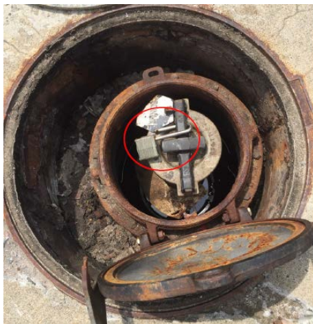
Photo 8 : Réservoir souterrain - Cadenas présent sur le réservoir, mais non barré
