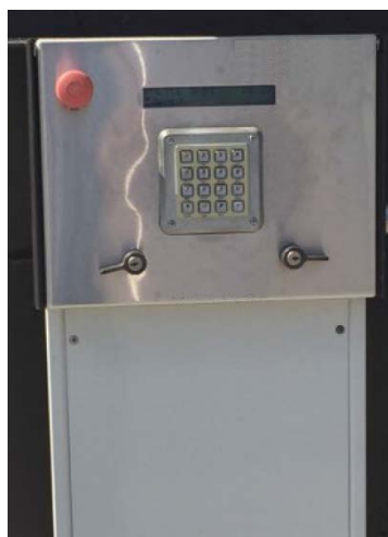
Photo 3 : Terminal du système de contrôle d'accès fermé, mais non barré
