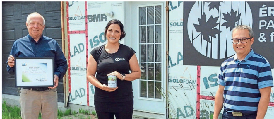
Michel Bourassa, maire de Saint-Alexis-des-Monts, l'acéricultrice Bianka Pagé et Serge Berthiaume, coordonnateur d'Agroa Desjardins, devant la cabane à sucre en construction. Photo courtoisie
