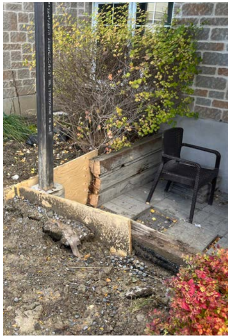
Les travaux de réfection ont coûté environ 30 000 $ jusqu'à maintenant. (Photos : Jean-Christophe Noël)
