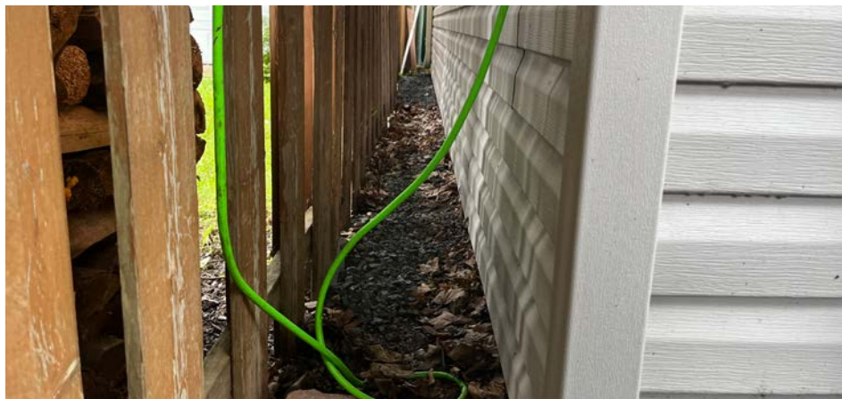
La Ville réclame 1,5 mètre de distance entre le garage et la ligne de terrain. (Photos : Jean-Christophe Noël)
