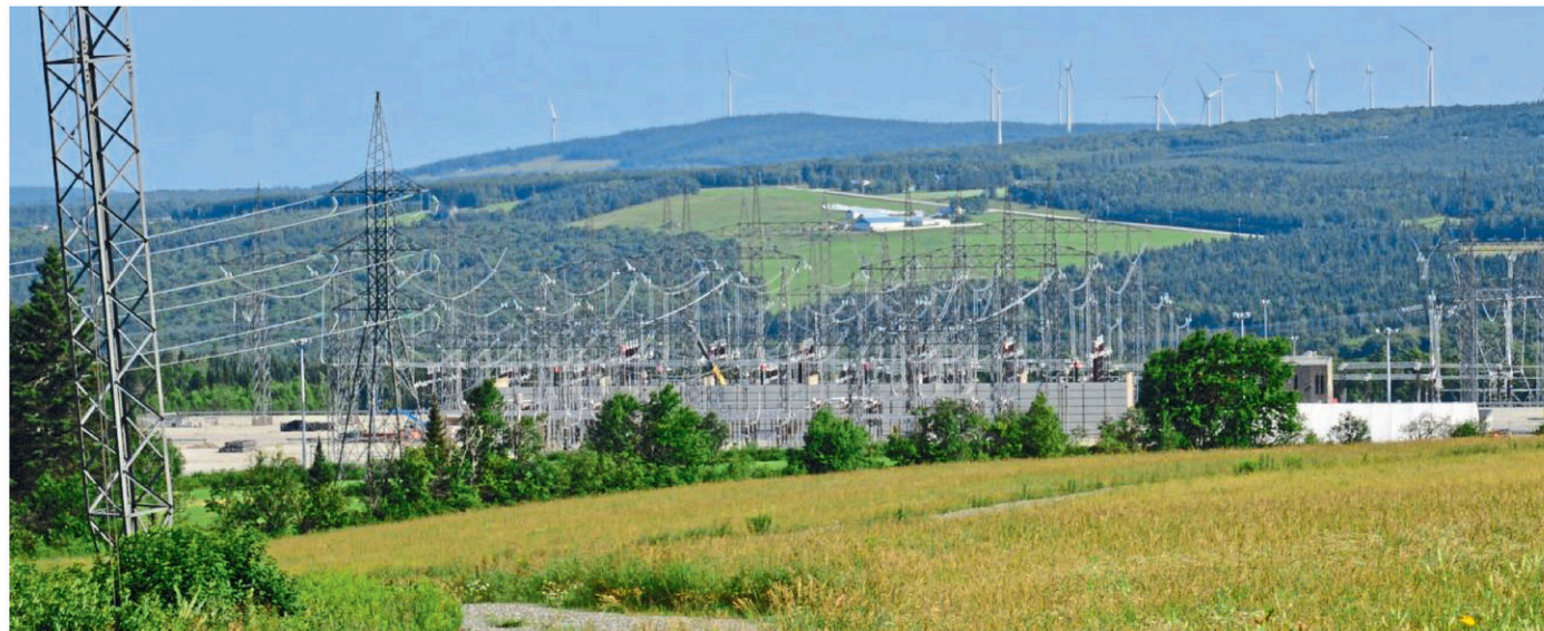
Le poste de Saint-Adrien-d'Irlande accueillera la nouvelle ligne de transport d'électricité. (Photo Courrier Frontenac - Jean-Hugo Savard)
