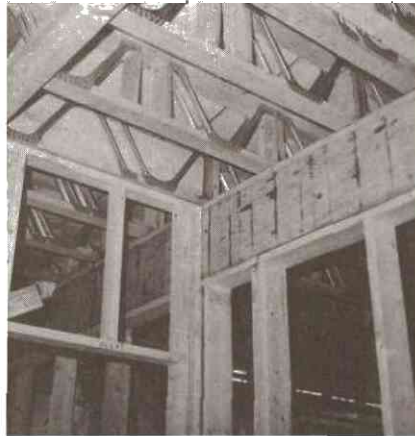
Industrialisation du chantier : poutrelles ajourées sur solive en bois lamellé et collé.
