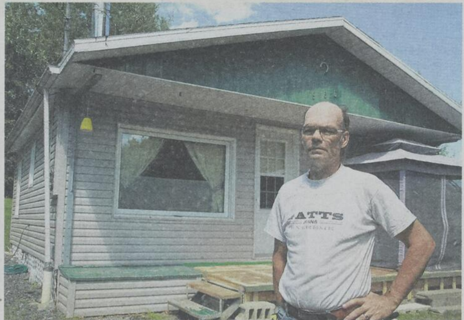
Hugues Lemieux devant sa résidence endommagée par le dynamitage.
