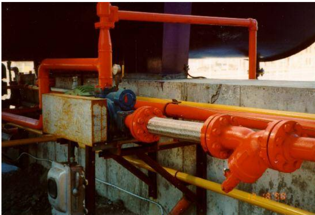
Figure 5 Tuyauterie sous le réservoir de propane
