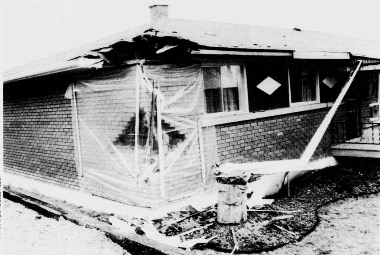
Un camion en cavale a lourdement endommagé cette maison de la rue Bowen Sud, à Sherbrooke.
