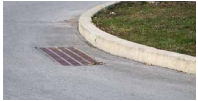
Figure 7.17 Grille à plus grande capacité au point bas.
