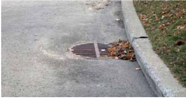
Figure 7.16 Accumulation de débris au point bas.
