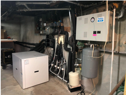
Équipements, dont la thermopompe, dans le sous-sol du bâtiment
