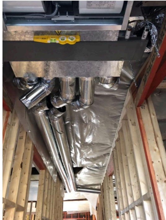
Conduits pour la distribution de l'air (chaud ou froid) dans les logements
